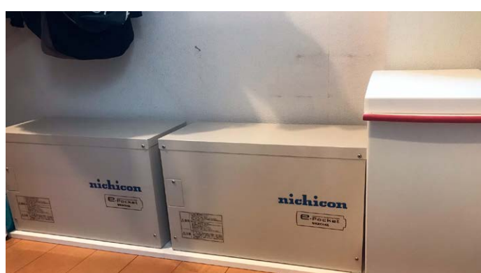
蓄電システムは納戸に設置。
